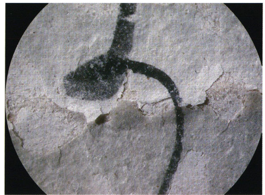
修理前の装飾層の状態
